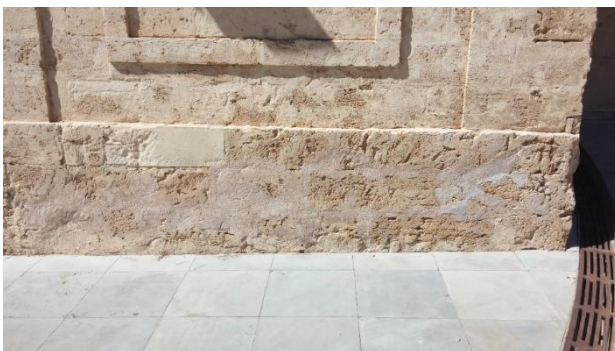
Il·lustració 11. Detall del desgast del marès a la socolada de la façana.
