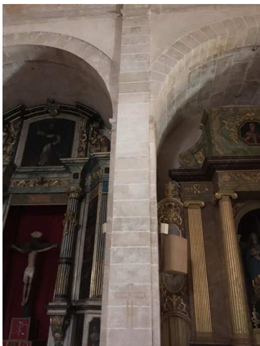
Il·lustració 9. Pilastra entre les capelles de les Ànimes i la de la Puríssima. S'aprecien les diferències de tractament i desgast del marès.
