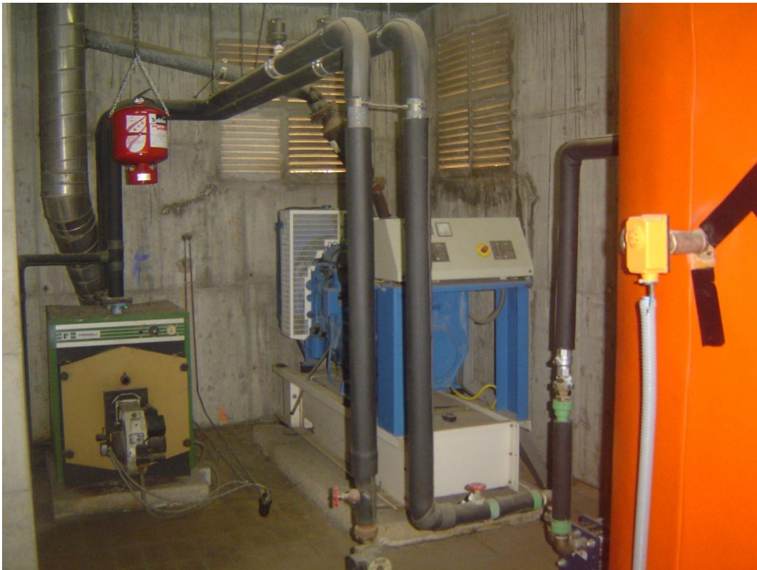
Vista de la caldera, grup electrogen i acumulador d'ACS
