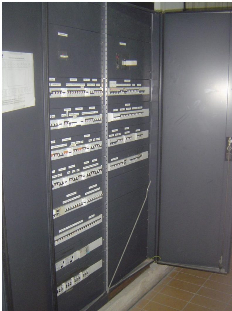
Vista del quadre elèctric general
