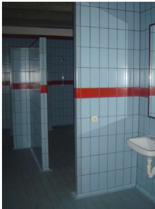
Vista de les dutxes d'un vestuari en planta -1
