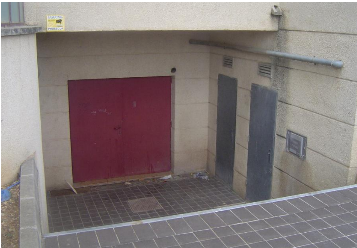
Vista general de la sortida d'emergència nº 7 i sala de comptadors elèctrics
