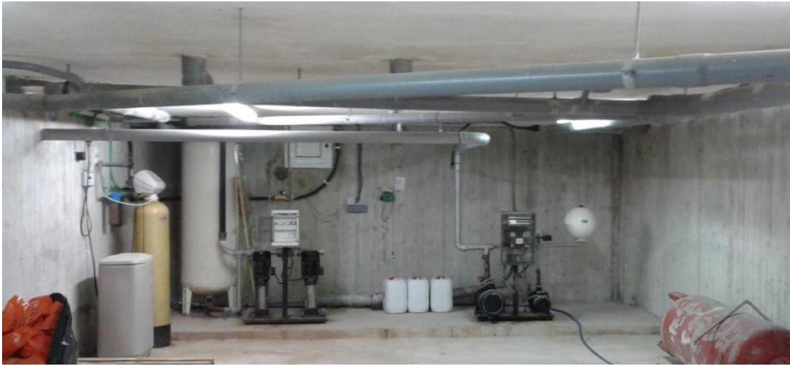
Vista general de la sala de maquines planta -2
