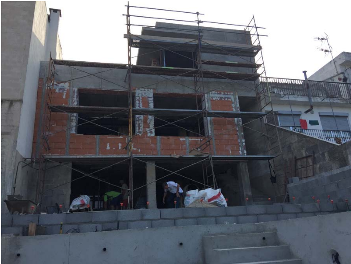
Fotografia 33– Piscina i contenció de jardí en procés. Acabats de façana amb bastines no normalitzades.
