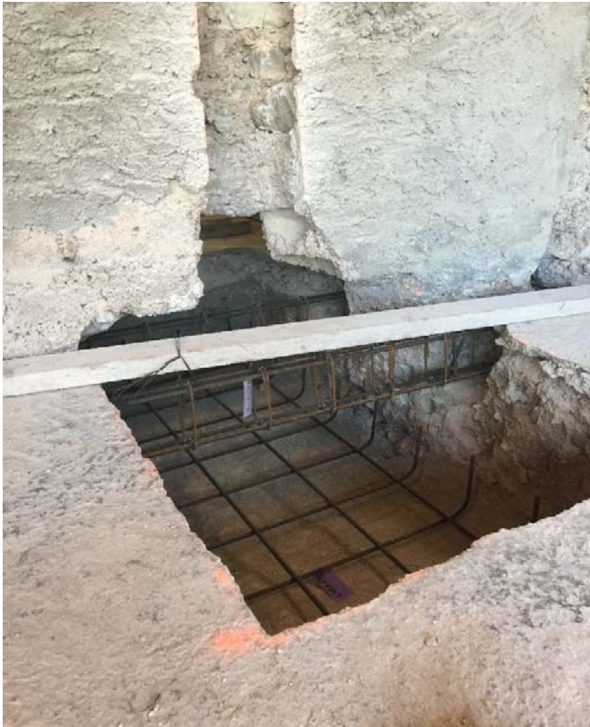
Fotografia 5 – Debilitació considerable de l'estructura existent per a l'execució del reforç de l'estructura
