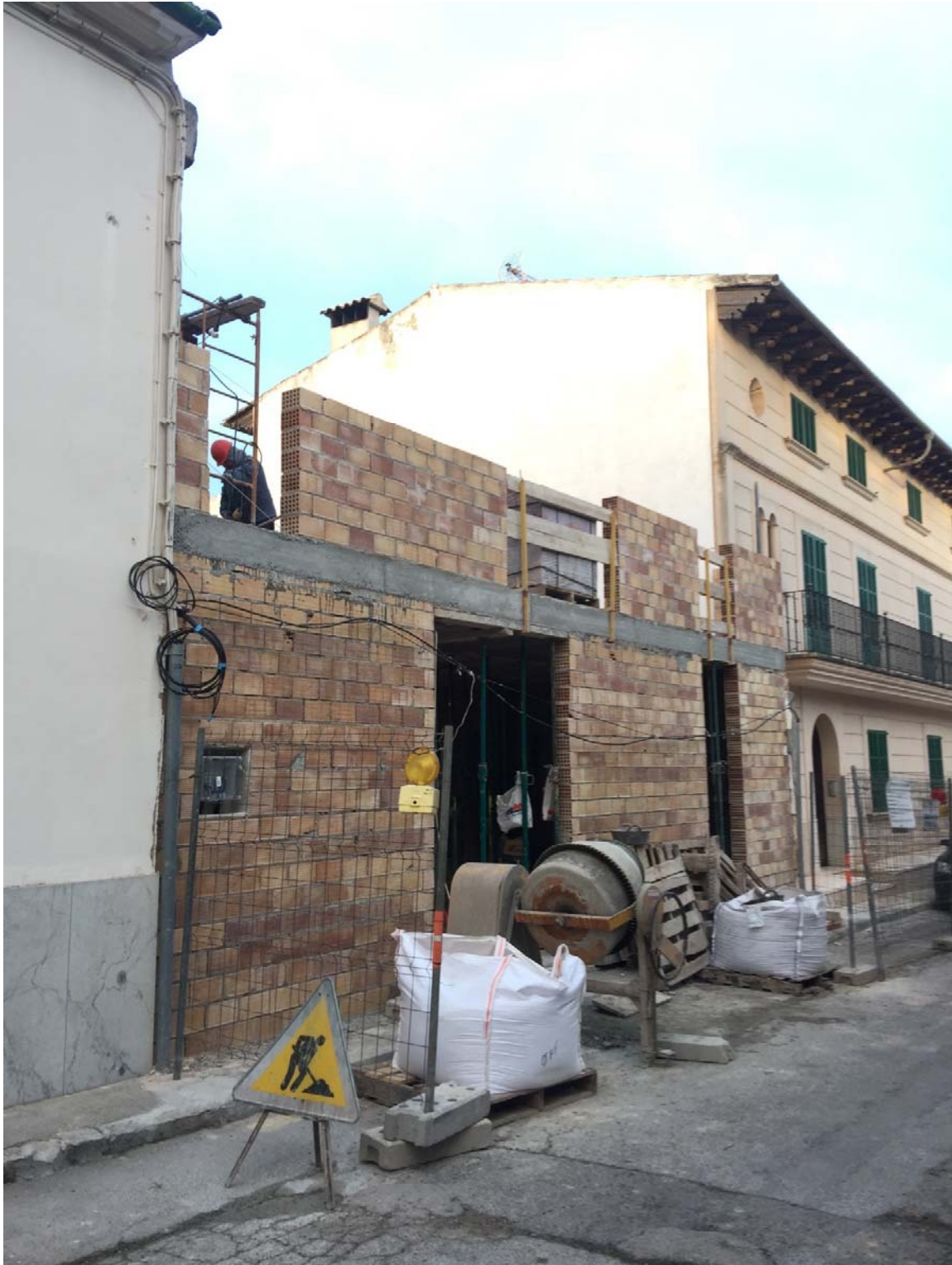
Fotografia 16 – Façana principal on es veuen les baranes incompletes i el buit desprotegit
