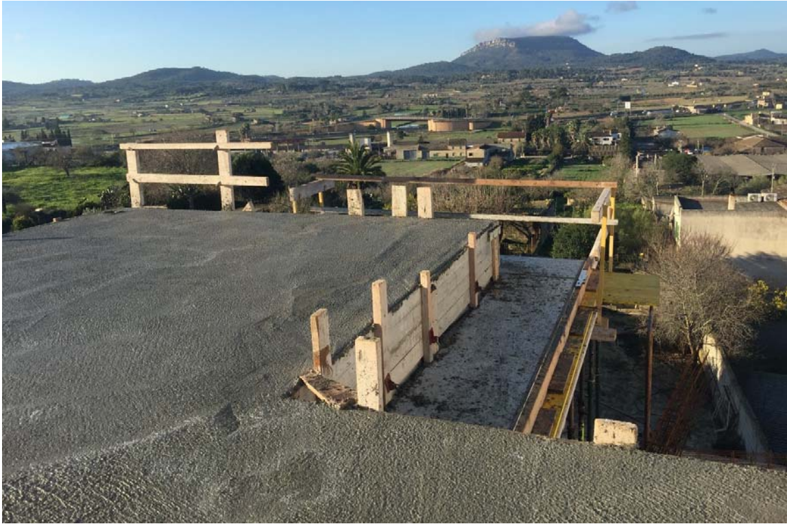
Fotografia 20 – Formigonat de forjat pla sobre planta pis. Falta de proteccions perimetrals
