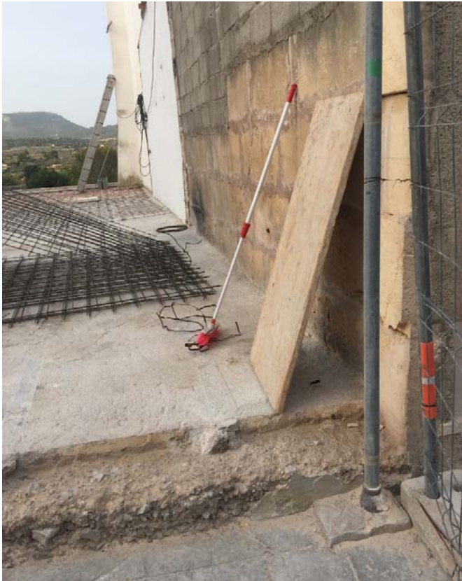
Fotografia 9 – Replanteig del mur de càrrega de façana on s'acorda retranquejar-se 5 cm pel posterior aplacat de marès
