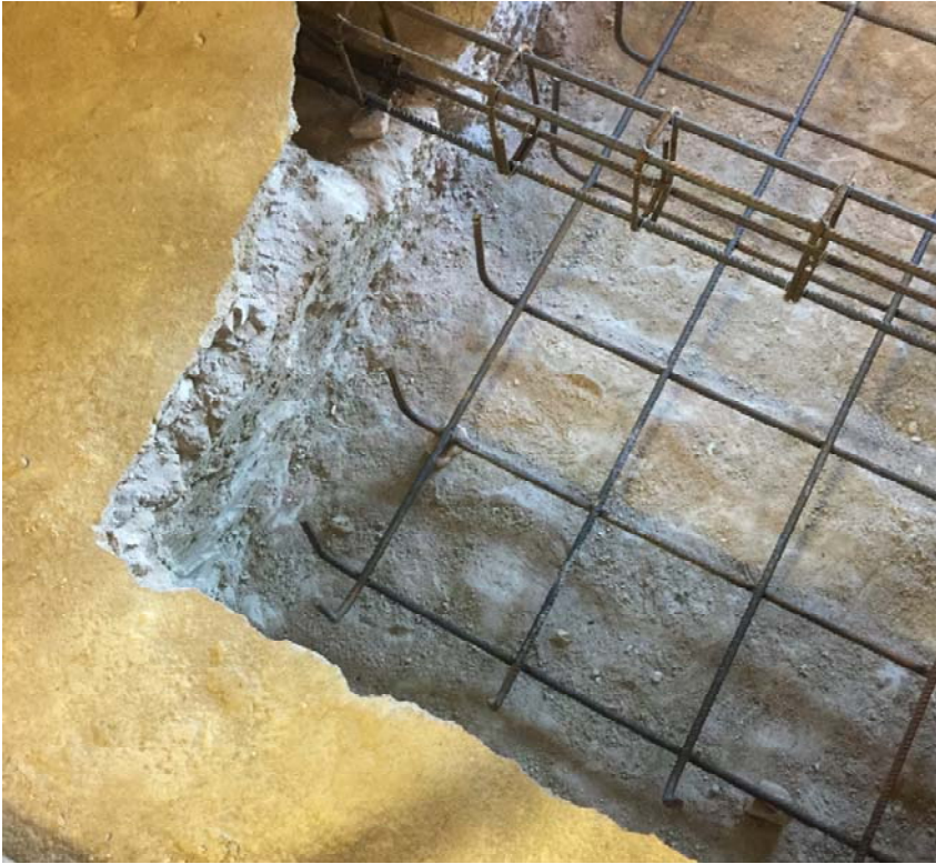
Fotografia 7 - Detall dels separadors emprats, on també s'observa, igual que a la resta de fotografies la inexistència de formigó de neteja i de protecció de les armadures
