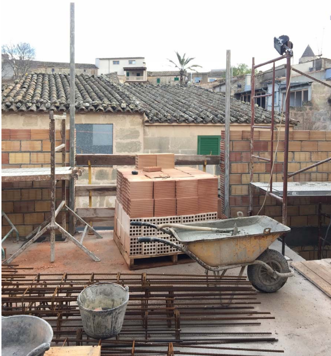
Fotografia 17 – Bastida situada al buit d'escala i falta de protecció perimetral d'aquest
