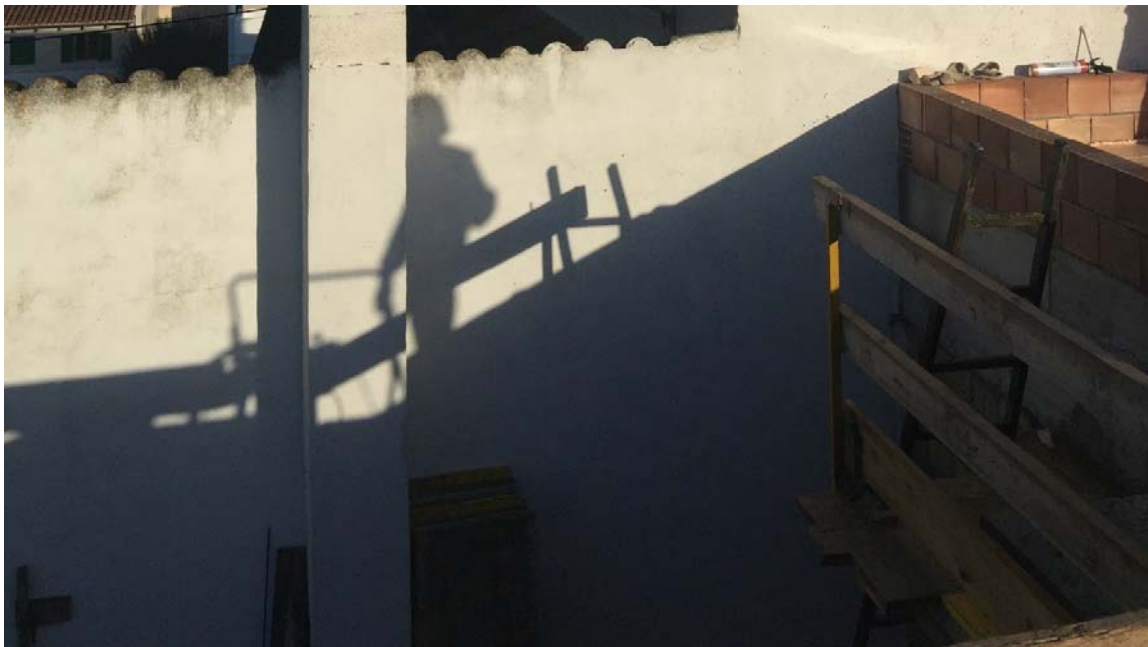
Fotografia 30 - Accés a la coberta plana a través d'escala metàl·lica recolzada a l'encofrat
